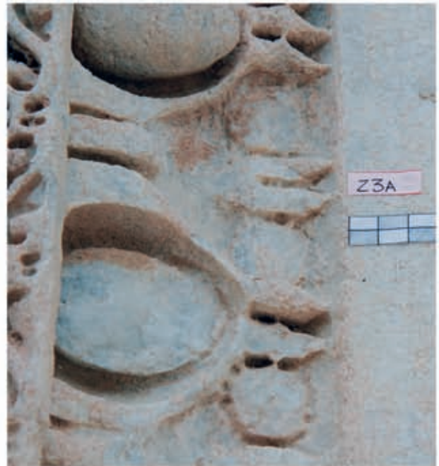
2 Kleinteilige Ausbrüche von Eier- und Perlstab im Bereich der Türrahmung, 076T
