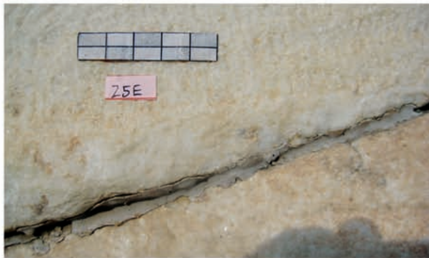
3 Postament 007I : verklebter Riss
