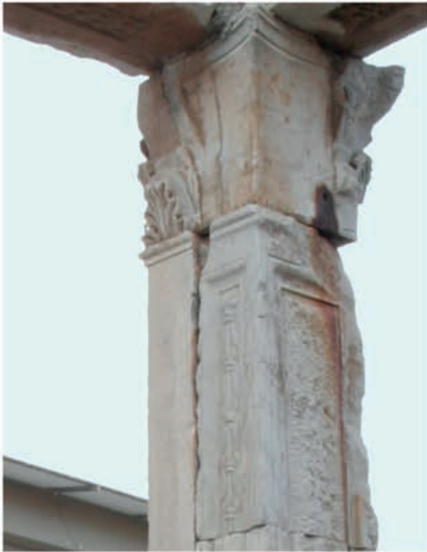
1 Kapitell 014K , Pfeiler 010S : Eisenverfärbung
