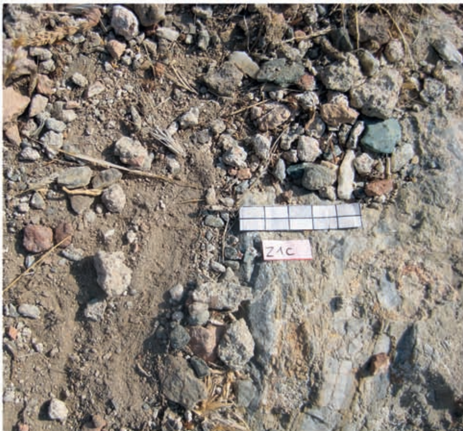
3 Horizontale Fläche der Mauerkrone der Cella-Ostwand mit Erde und biogener Besiedlung
