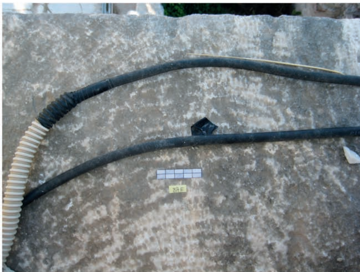
3 Freiliegende Verkabelung auf der Mauerkrone der Westwand
