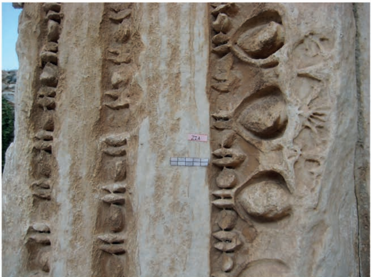
2 Türpfosten 082T : Reste von ausgetretenem Zementleim an der Oberfläche
