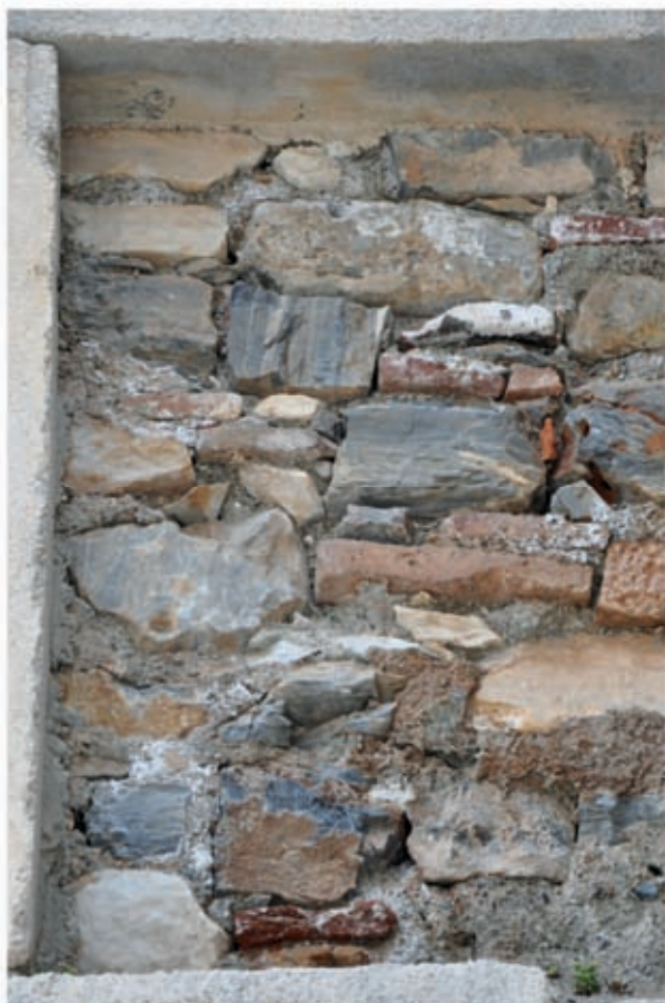
3 Schadsalze am rekonstruierten Bruchsteinmauerwerk
