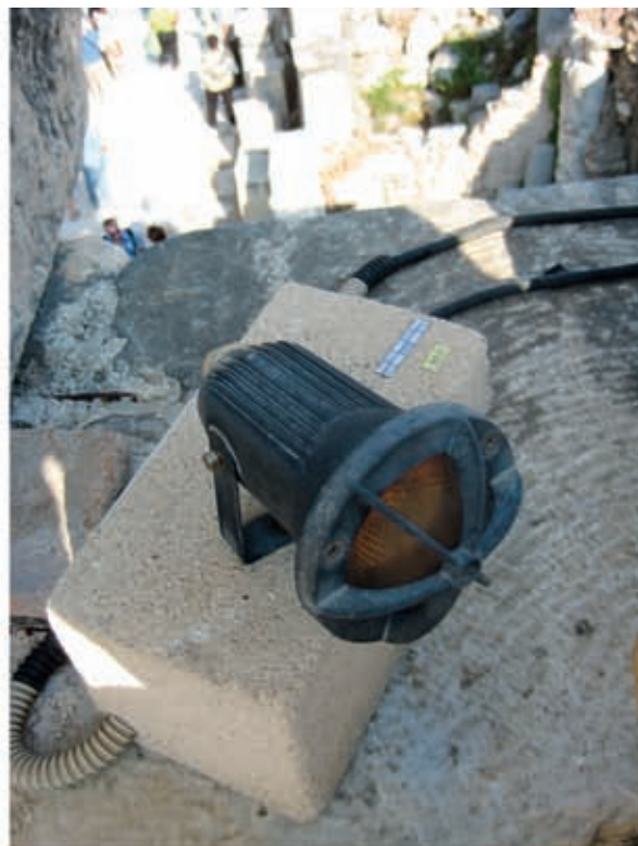
2 Lampe auf der Mauerkrone der Westwand
