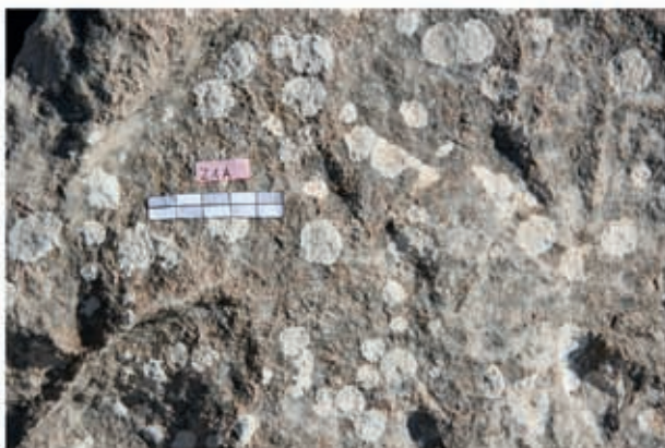
5 Biogener Bewuchs auf einer exponierten Fläche der Mauerkrone 045G
