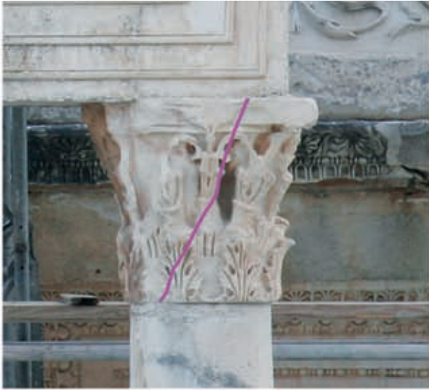
1 Kapitell 018K : Verlauf des vorhandenen Rissystems
