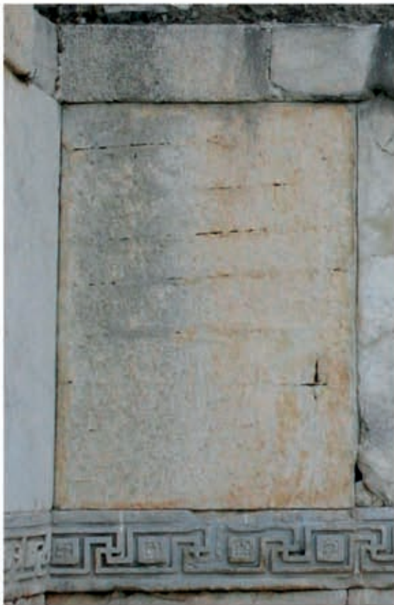
3 Sich abzeichnendes Bewehrungsnetz an Orthostat 0680e
