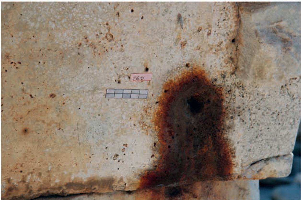
3 Kapitell 025K : Eisenverfärbung an der Oberfläche
