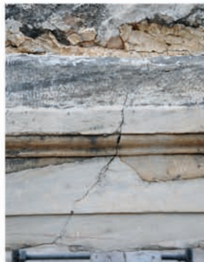
4 Architrav 040A : vertikaler Riss in der Blockmitte
