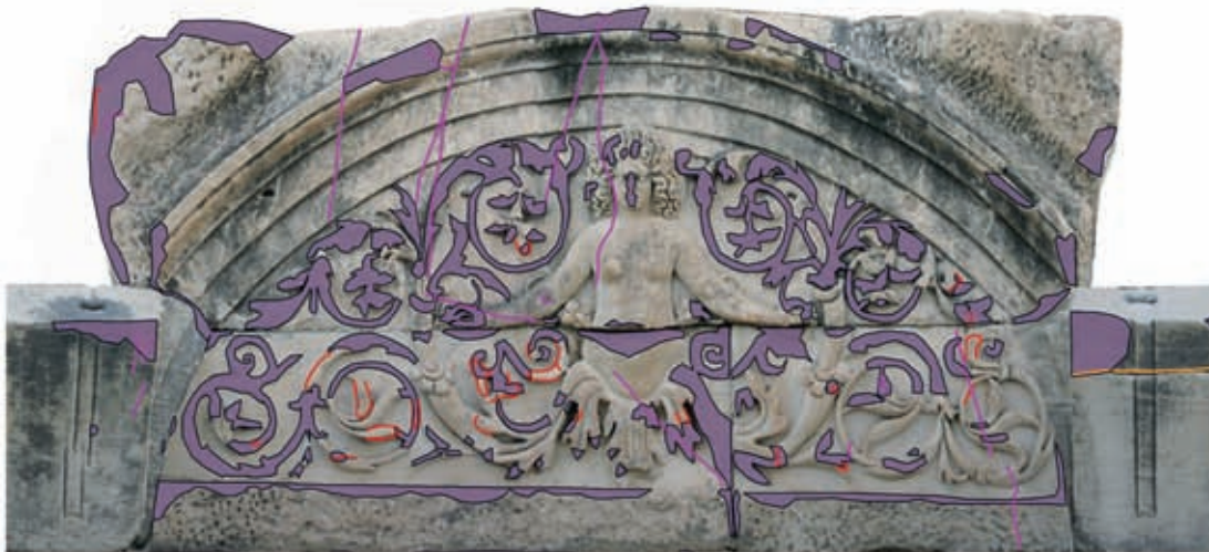
2 Tympanonrelief: gesteinsimmanente Risse (rot), Einzelrisse (magenta), Verluste an Gesteinssubstanz (violett)
