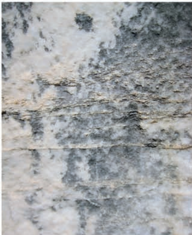
3 Rückgewitterte Steinoberfläche mit herauspräparierten Dolomitadern
