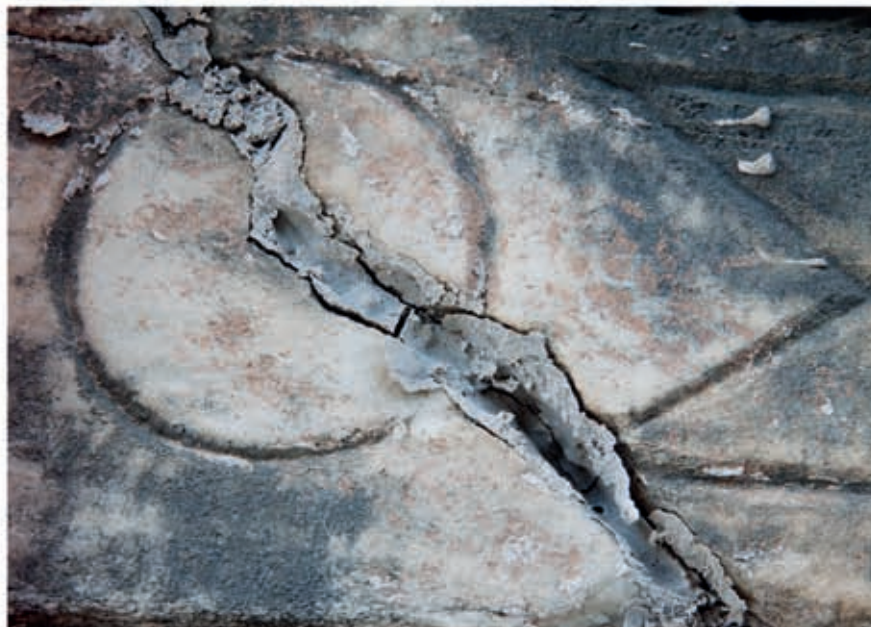
4 Architrav 040A : verklebter Riss mit sekundärem Rissnetz der Klebung
