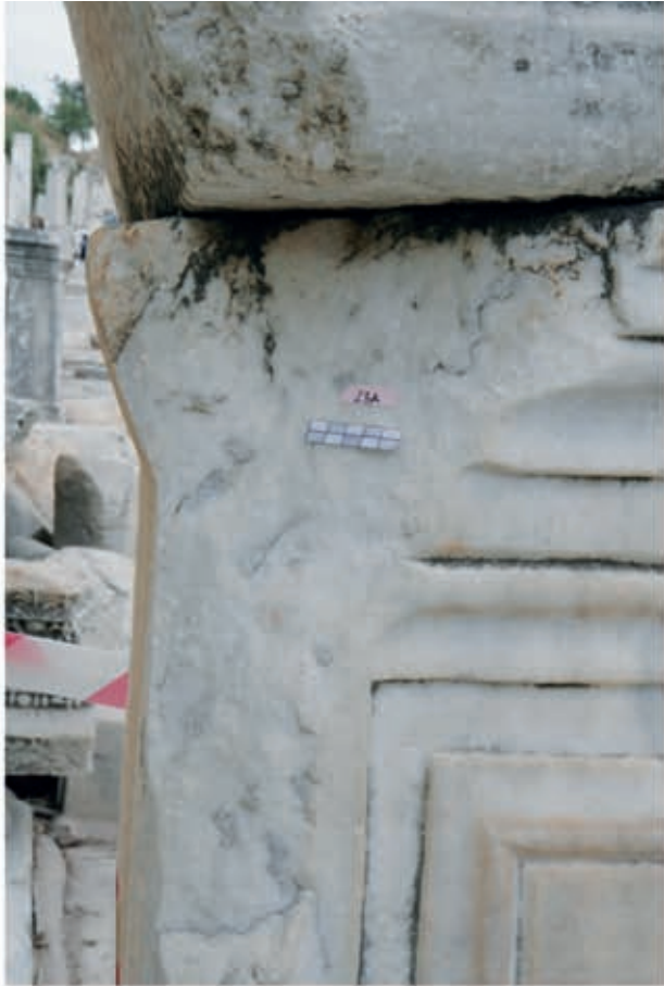
1 Großflächiger Ausbruch am Podest des Constantius (0091)
