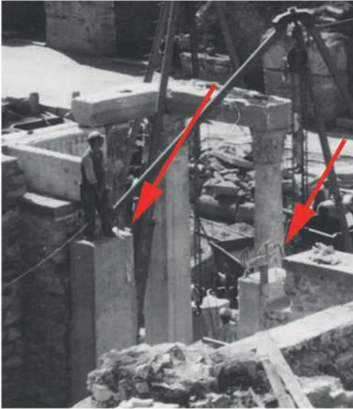
1 Wiederaufbau: Enden der gegossenen Türleibung (172Te. 173Te) mit hervorstehenden Bewehrungsseisen
