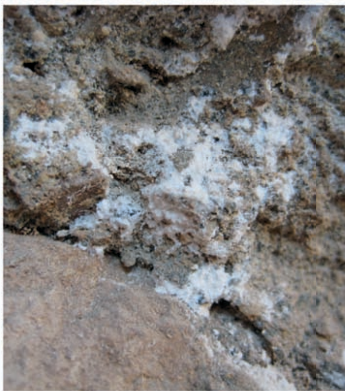
4 Detailaufnahme der Schadsalze
