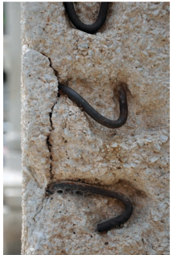
3 Ausbrüche des Betons aufgrund oberflächennaher Bewehrungen
