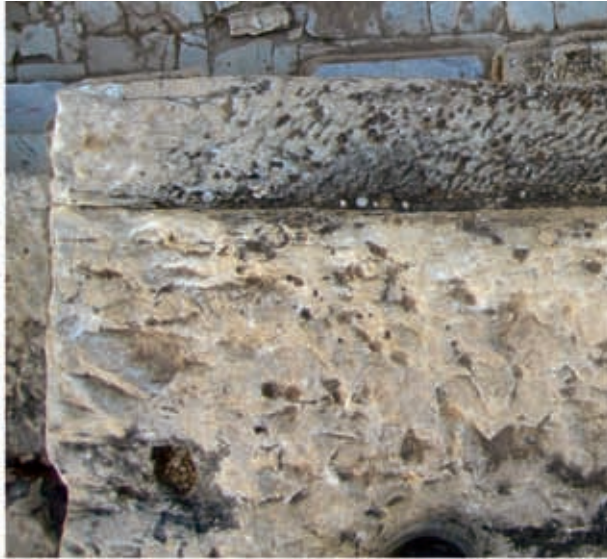
1 Gesteinsimmanente Risse an der Oberseite von 042G
